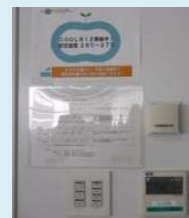
フロアの室温管理
