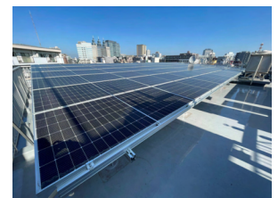
屋上に設置した太陽光パネル
