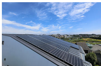
太陽光発電システム
