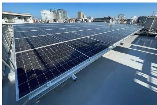
再生可能エネルギーの活用
