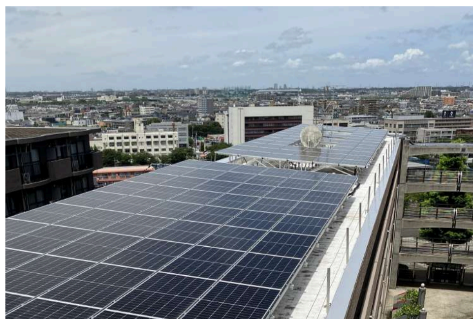
太陽光パネル
