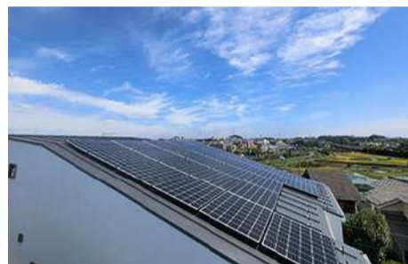
太陽光発電システム
