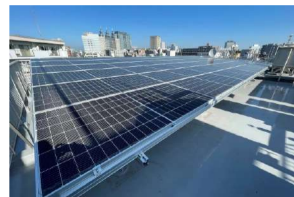
屋上に設置した太陽光パネル
